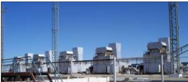
Компрессорная станция "Найт" (Туркменистан) с двигателями ДТ70П
