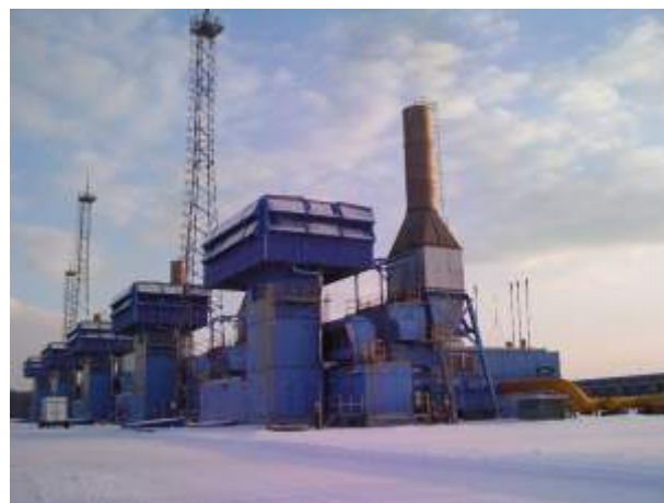
Агрегаты ГПА-Ц-16С с двигателем UGT 15000 на компрессорной станции Слонимская, Беларусь
