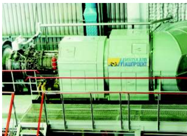
Модернизированный агрегат ГПА-25/76 в машинном зале КС Софиевская
