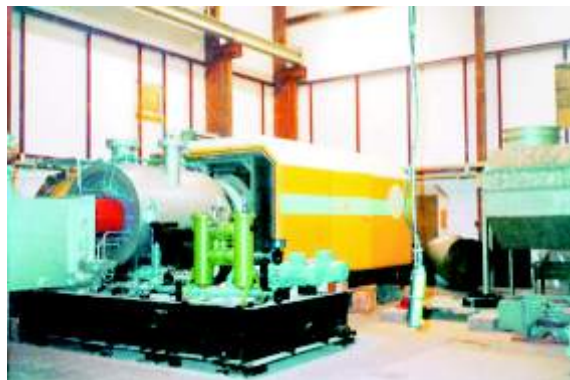
В машинном отделении на подземном хранилище “Штрамберг”
