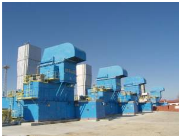
Компрессорная станция "Кардам" (Болгария) с двигателями ДТ70П
